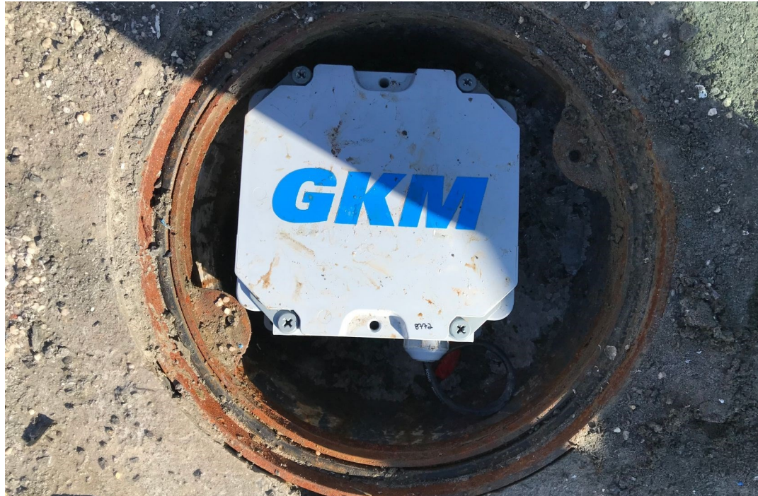
Acquisition de données - en temps réel - intégré dans une boîte de service
